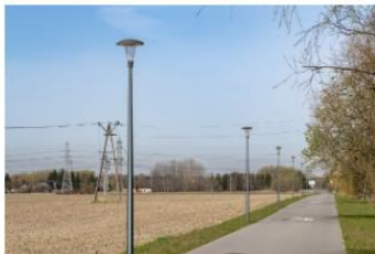
Oświetlenie przy ścieżce rowerowej w Michałowicach
