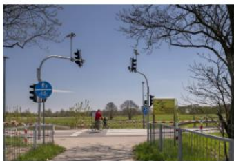
Sygnalizacja przy Raszynce
